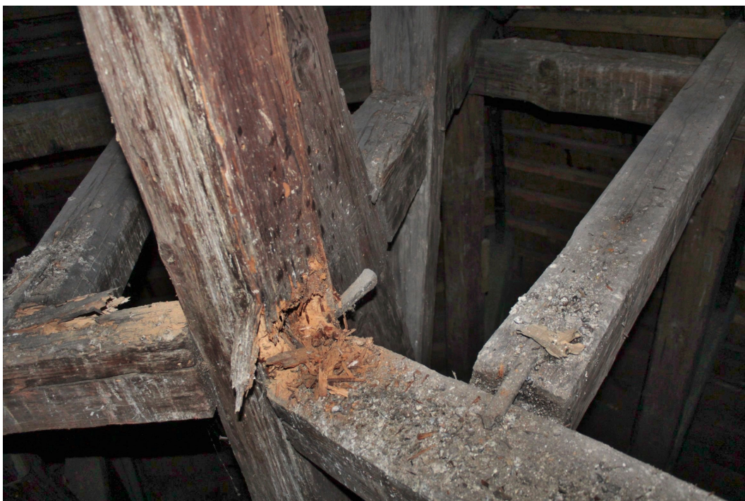
12. Vaznicový věnec a sloupek štenýřové konstrukce, poškozený houbou a tesaříkem
