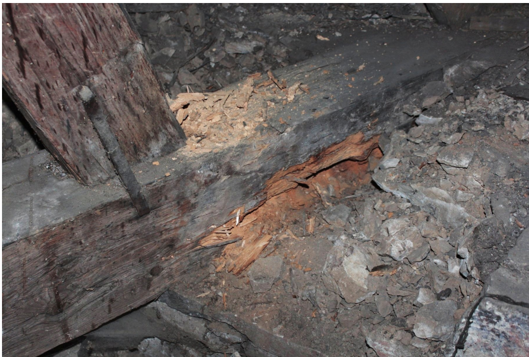
7. Silně poškozené zhlaví vazného trámu, napadeného houbou a tesaříkem.
