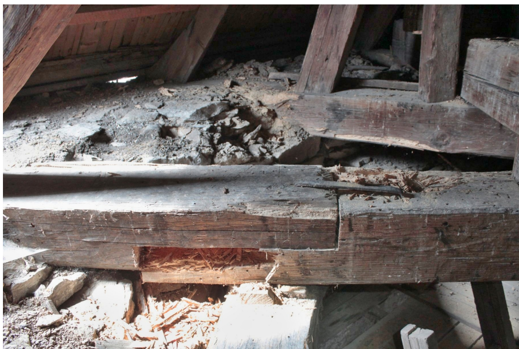
5. Řemeslně nekvalitní oprava napadeného zhlaví vazného trámu s ponecháním (nebo pokračováním) napadení v neodříznuté původní části trámu.
