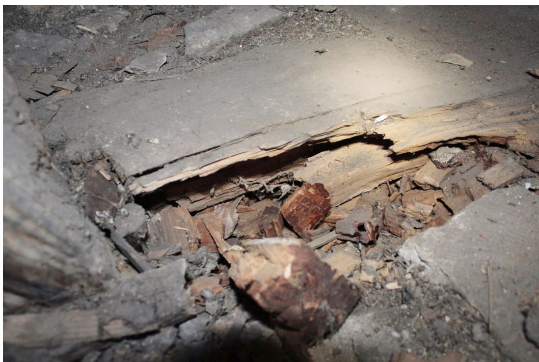
6. Silně poškozené zhlaví vazného trámu, napadeného dřevomorkou a červotočem.
