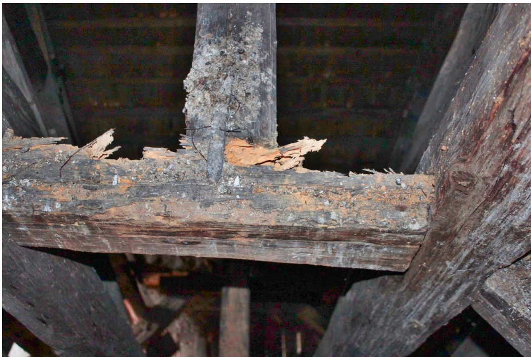
11. Vaznicový věnec osmiboké štenýřové konstrukce a navazující hambalek, poškozený tesaříkem
