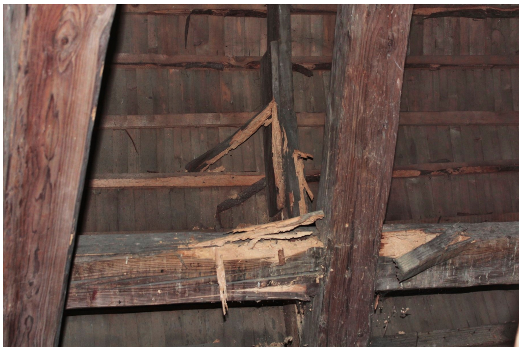
10. Vnější vaznicový věnec a ramenát, silně poškozený tesaříkem
