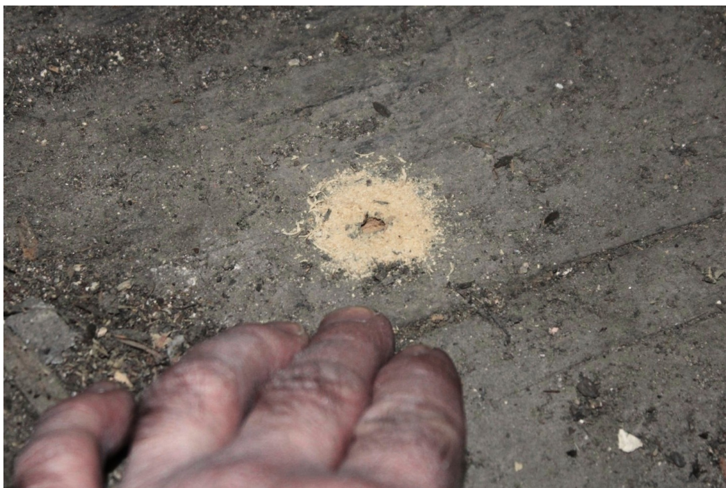
8. Příklad čerstvého výletového otvoru, prokazující aktivitu tesaříka
