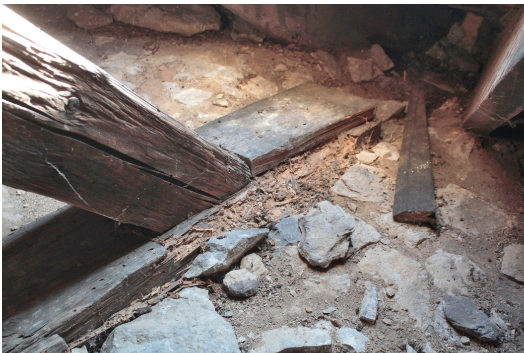
4. Silně poškozené zhlaví vazného trámu tesaříkem.
