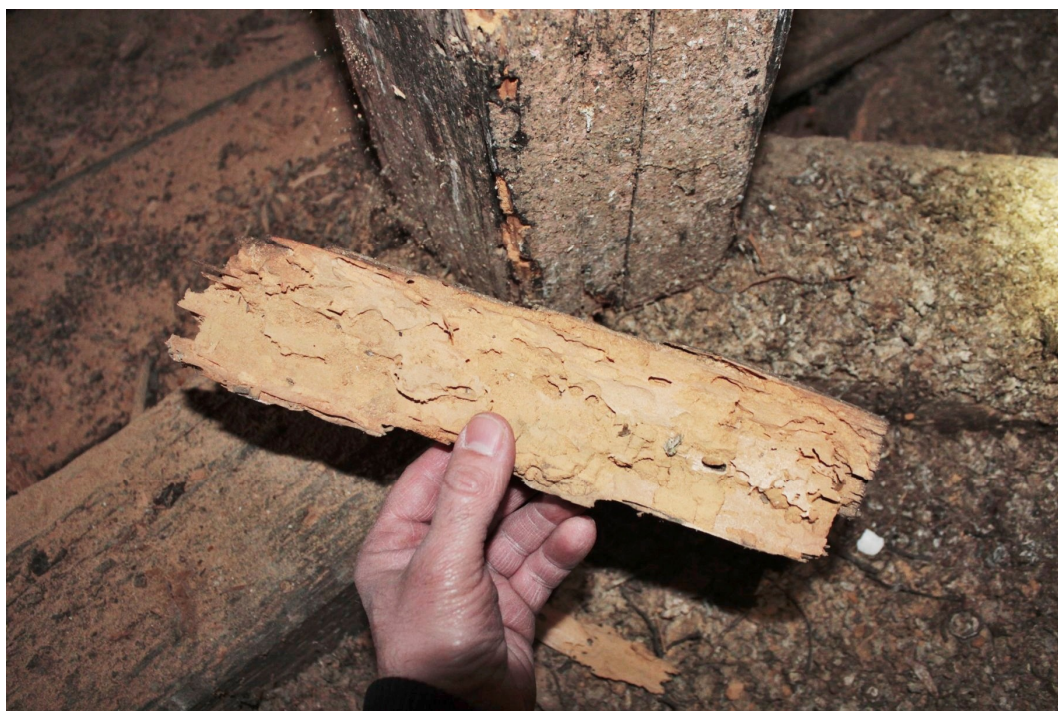
9. Povrchová vrstva trámu, silně poškozená působením tesaříka
