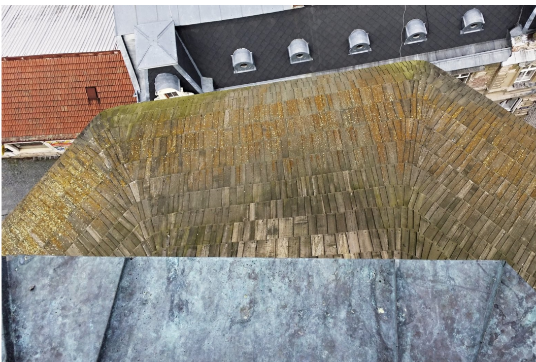
2. Zhoršený stav střešního šindele porostlého řasami a lišejníky.
