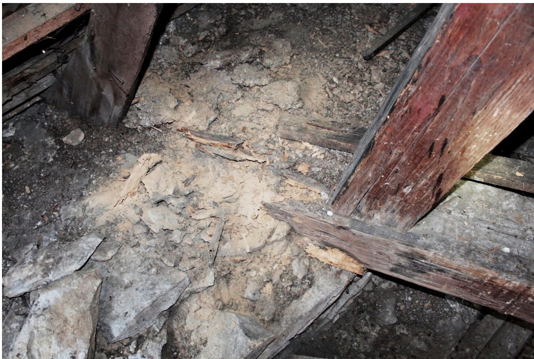
3. Zcela destruované zhlaví vazného trámu, napadeného houbou a tesaříkem.
