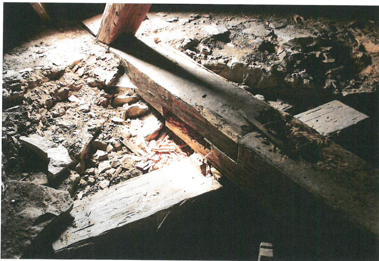
Obr. 29: Plátový spoj diagonálního vazného trámu narušený biotickým napadením (Rohlíček 2014).
