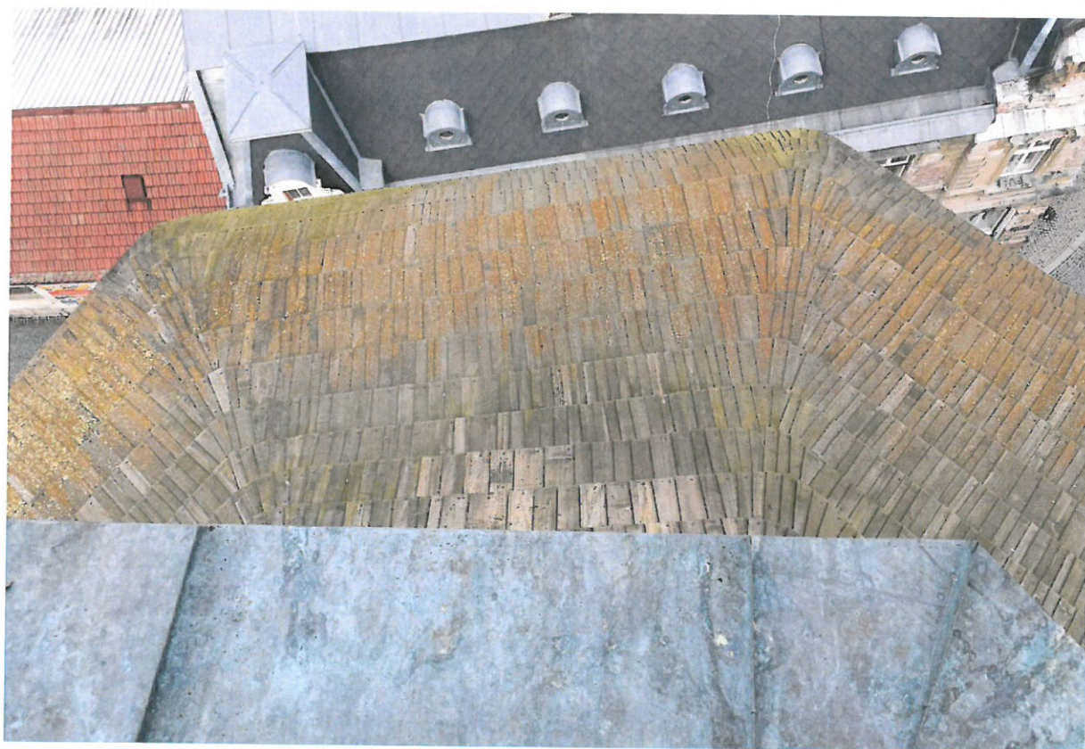
Obr. 11: Detailní pohled na již dožilou šindelovou krytinu (Rohlíček 2014).
