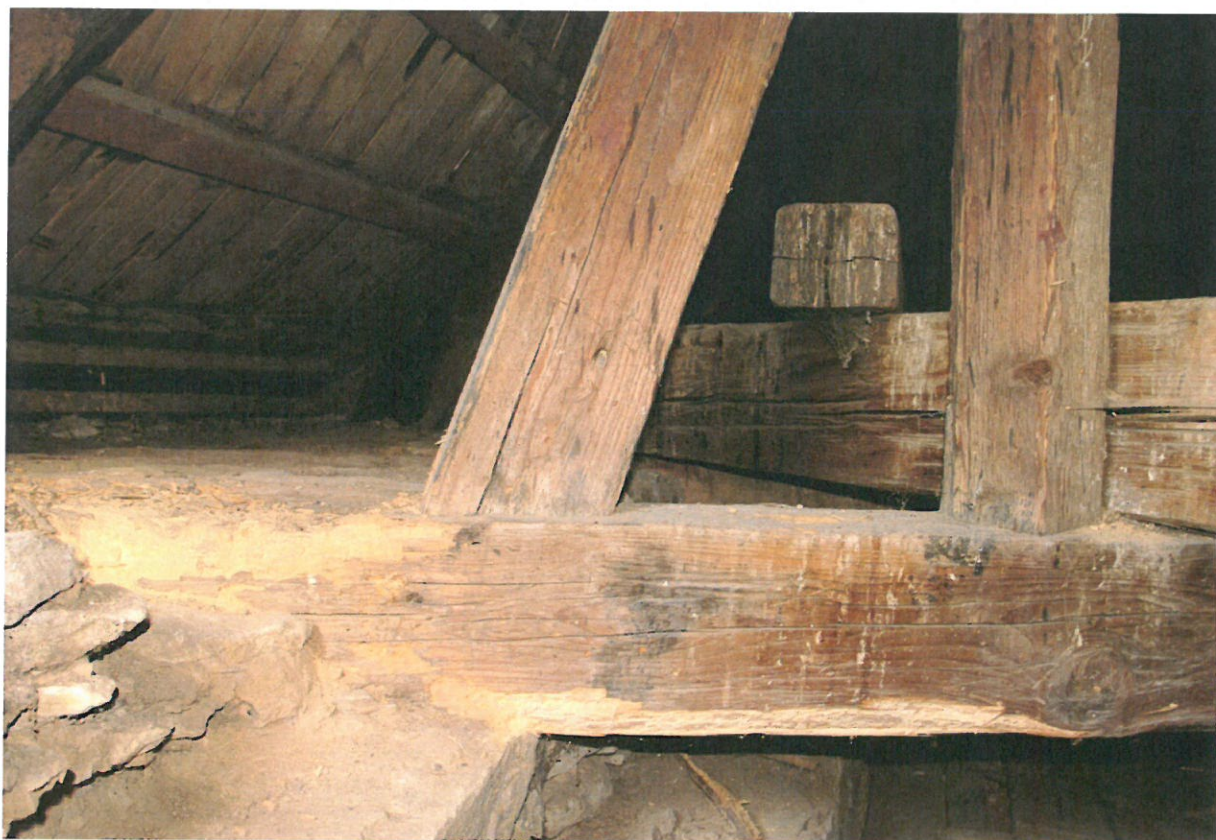
Obr. 26: Bioticky napadený vazný trám základového roštu (Kudrnovský 2014).
