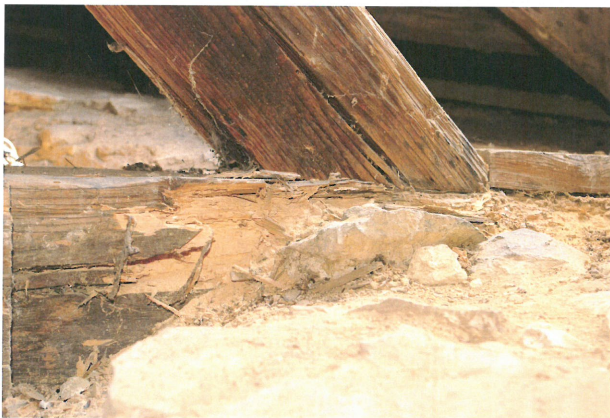
Obr. 27: Detailní pohled na napadení vazného trámu tesaříkem krovovým (Kudrnovský 2014).
