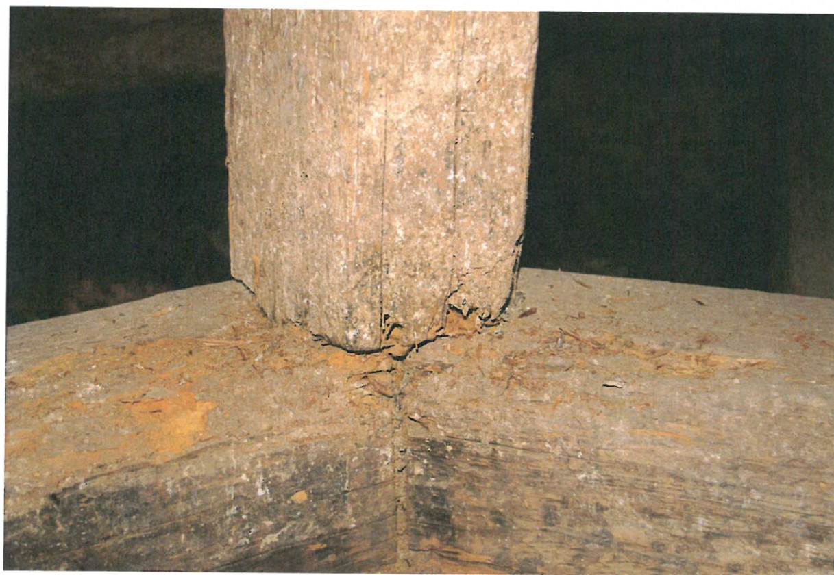
Obr. 21: Detailní pohled na bioticky napadený sloup štenýře v místě jeho začepování do osmibokého věnce (Kudrnovský 2014).
