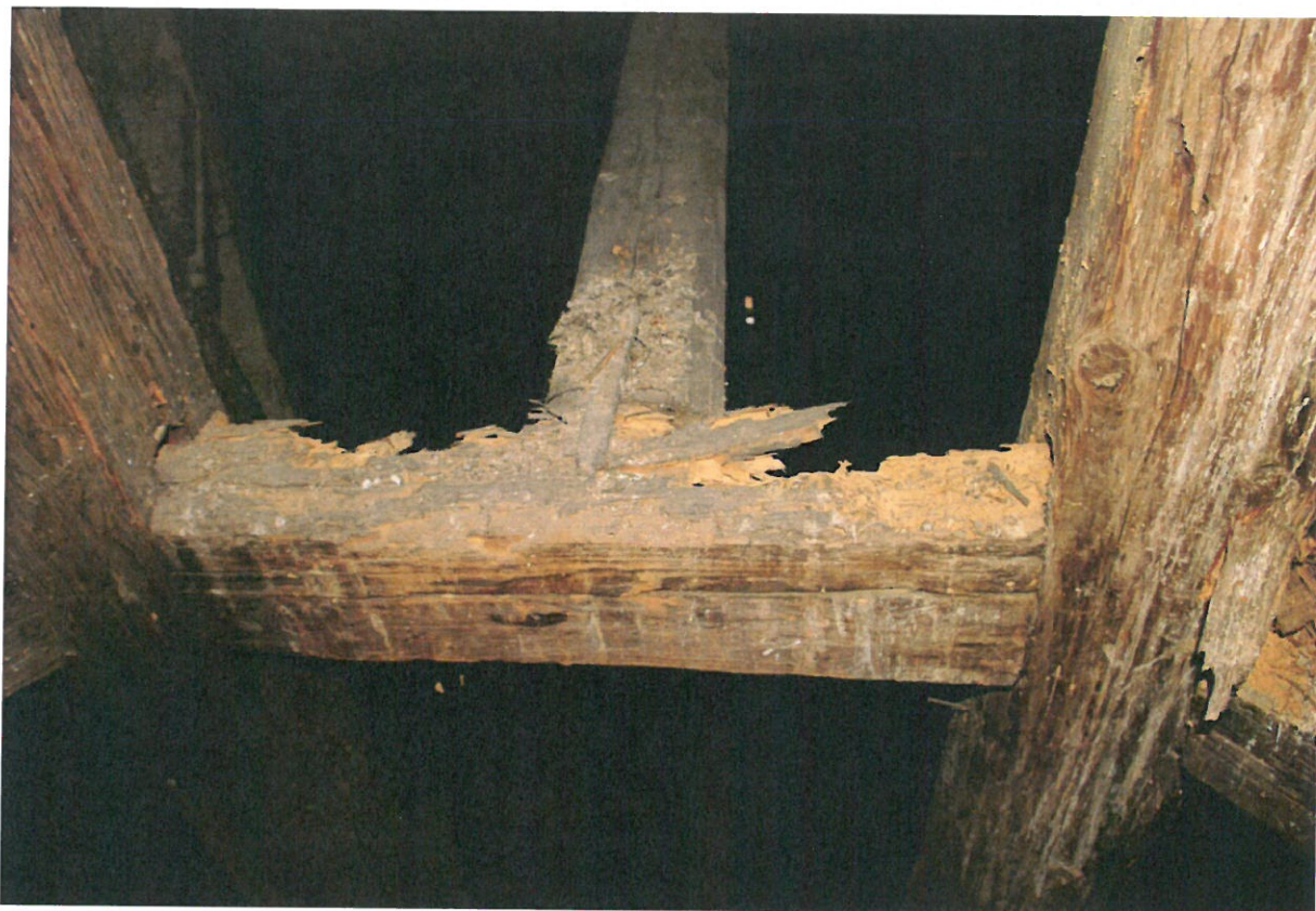
Obr. 35: Výrazně poškozený hambalek druhého patra začepovaný do osmibokého věnce. Spoj je jištěn tesařskou skobou (Kudrnovský 2014).
